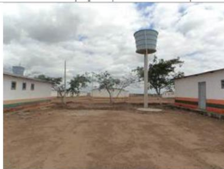
Canteiro de Obras – Lote2 – Não está sendo utilizado, Não há Instalações (Elétricas, Hidráulicas, etc.) (Ex.2016)
